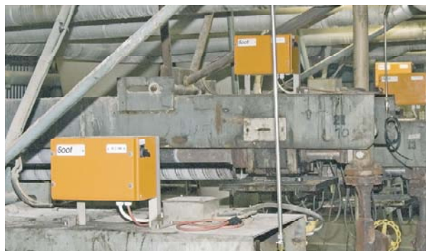
SootTech på Bäckhammars bruk
